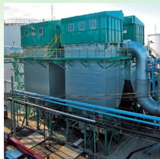
排ガス処理施設
